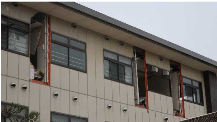
外壁の脱落被害
