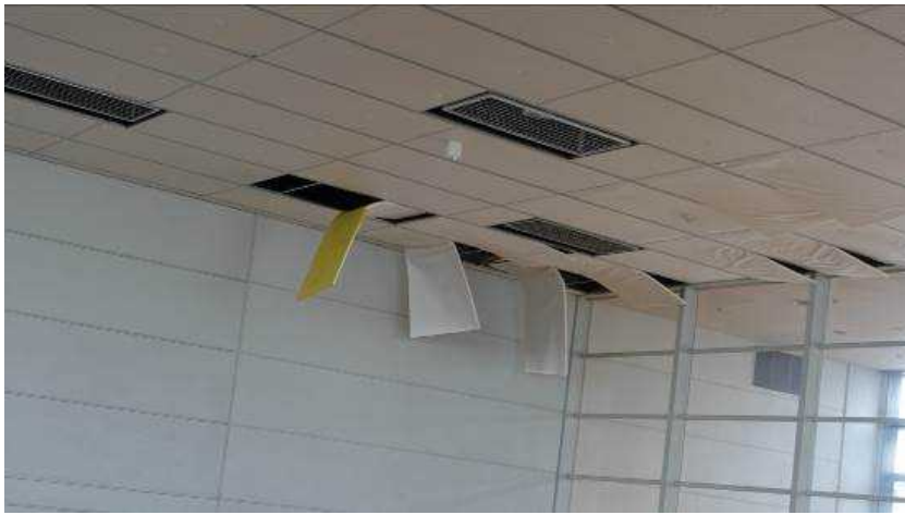
天井の落下被害
