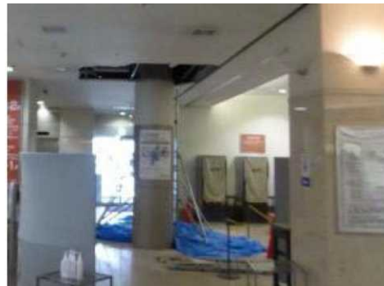
病院における天井の損傷
