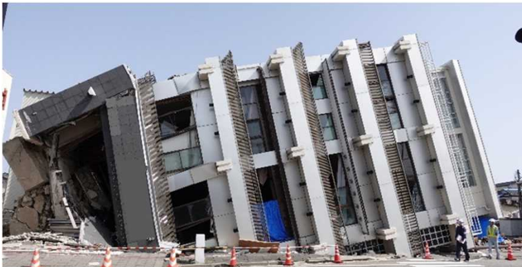
鉄筋コンクリート造建築物の転倒被害
