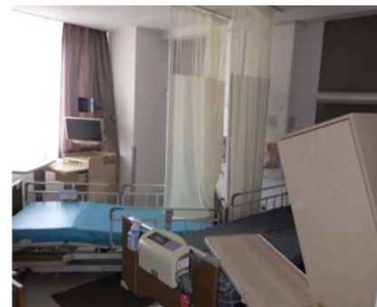
耐震構造の病棟の地震後の状況
