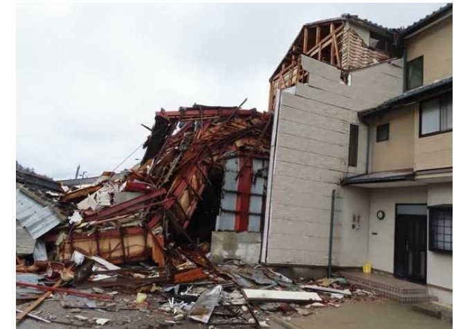
鉄骨造建築物の2階と3階が倒壊
