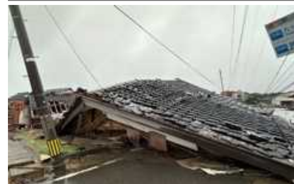
倒壊した木造建築物
