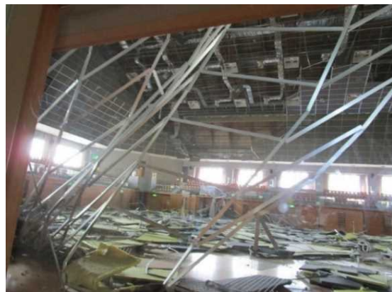
体育館における天井の損傷
