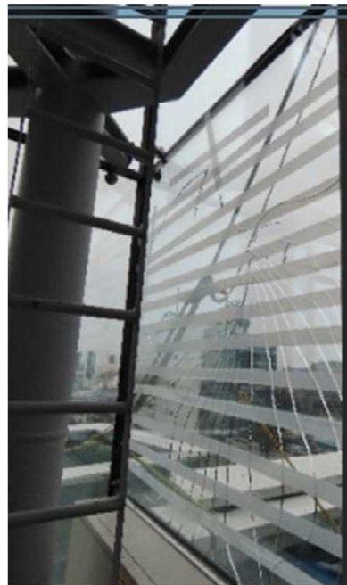
外装のガラスの割れの被害
