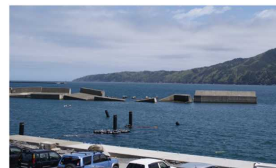
倒壊した波除堤の状況（宮古港）
